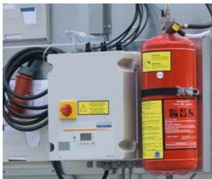
Рис. снизу: управление PLC, автоматическая система пожаротушения
