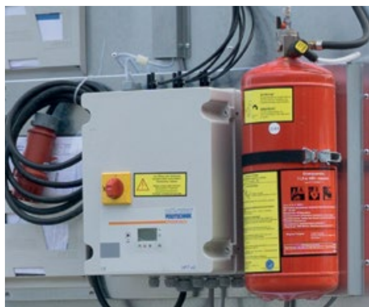
Рис. снизу: управление PLC, автоматическая система пожаротушения
