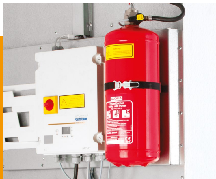
Рис. снизу: управление PLC, автоматическая система огнетушения
